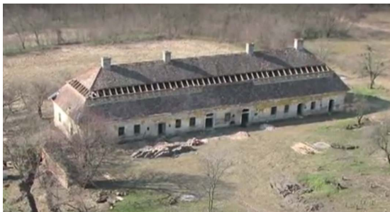
3. kép. A leromlott állapotú épület 5
